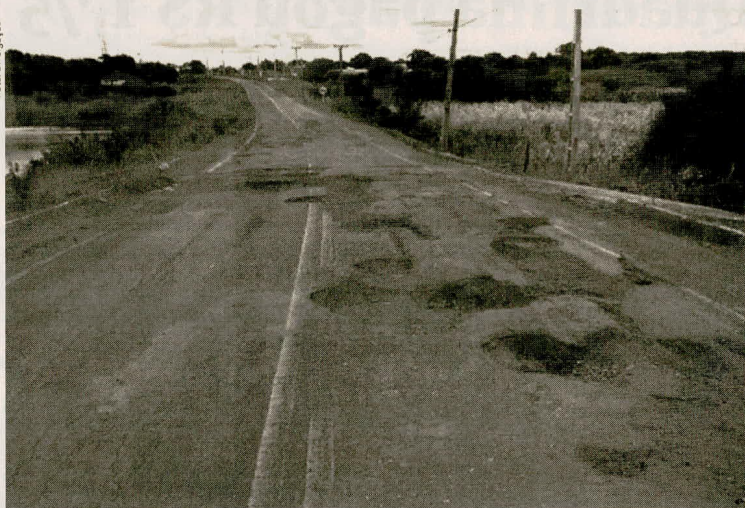
PI-245 encontra-se totalmente esburacada em alguns trechos
